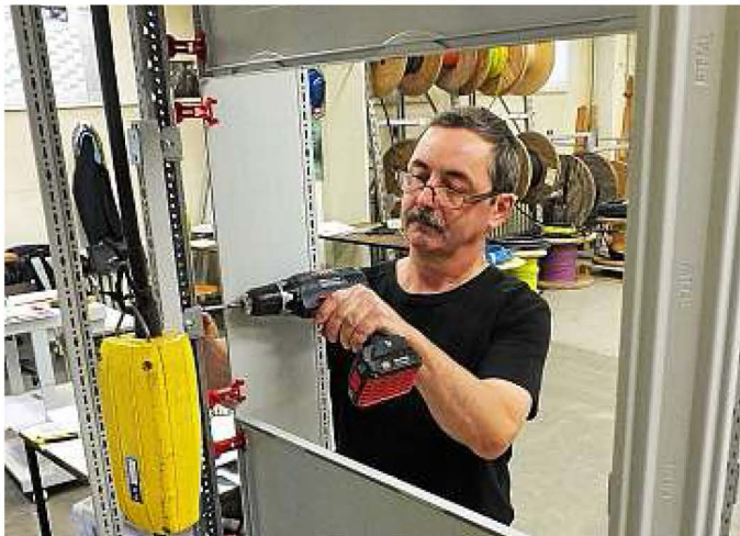
Jens-Uwe Rau montiert in der Fertigungshalle Schaltschränke für einen Industriekunden der Firma Starkstromanlagenbau Lobenstein. Fotos (2): Jens Voigt
